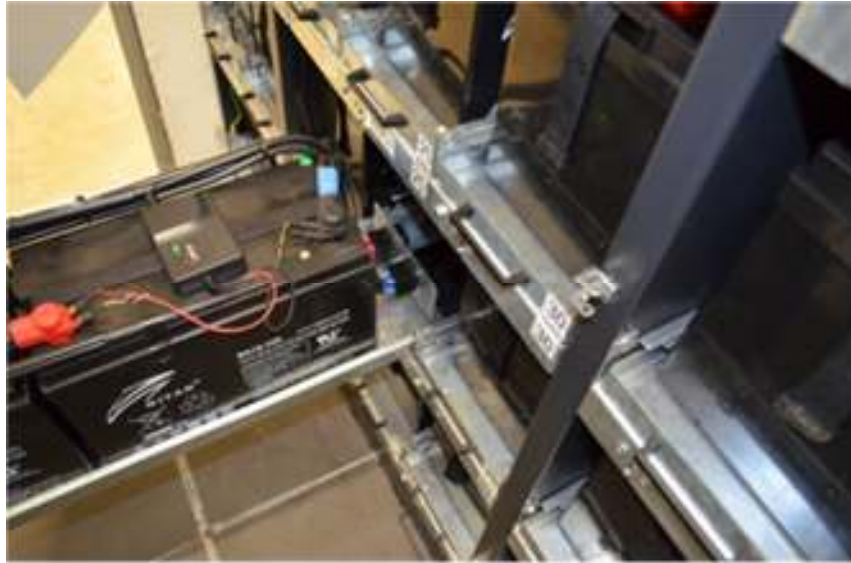
Detalhe da remoção de unidades a “quente”, possível pelo sistema Hot Swap.
