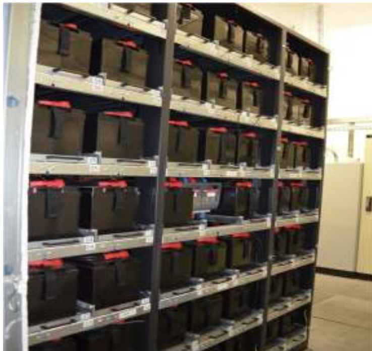
Imagens do gabinete especial de baterias
